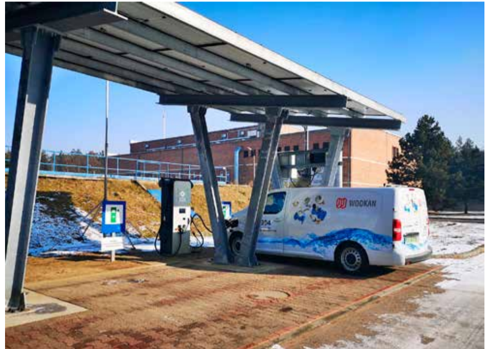
U uruchomiono stację ładowania pojazdów elektrycznych o mocy 60 kW mogącą obsłużyć do 3 stanowisk. WODKAN od lat stawia na elektromobilność, zasilaną energią słoneczną z własnego źródła.
