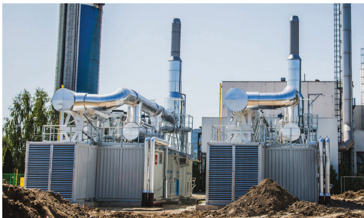
Silniki kogeneracyjne przy ul. Grunwaldzkiej 74A wybudowane w ramach dofinansowania: Działanie 1.6.: „Budowa wysokosprawnego bloku kogeneracji na potrzeby systemu ciepłowniczego Ostrowa Wielkopolskiego i Klastra Energii „Ostrowski Rynek Energetyczny”.
